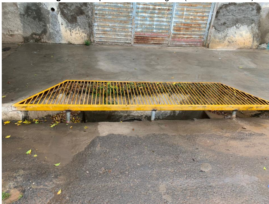
Figura 2- Dispositivo de drenagem (BOCA DE LOBO)
